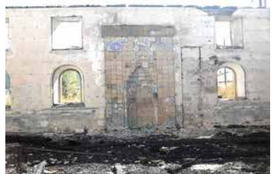
Fotoğraf 15: Sadak Köyü Cami Yangın Sonrası Güney Duvarı 2012, (Ç. B. DİKMEN ve F. TORUK Arşivi)
