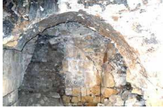
Fotoğraf 21: Sadak Köyü Hamam, sıcaklık kubbesinin giriş kısmı. Kubbeye giren kemerli kapı, duvarların üst kısmında yer almaktadır. (Ç. B. DİKMEN ve F. TORUK Arşivi )
